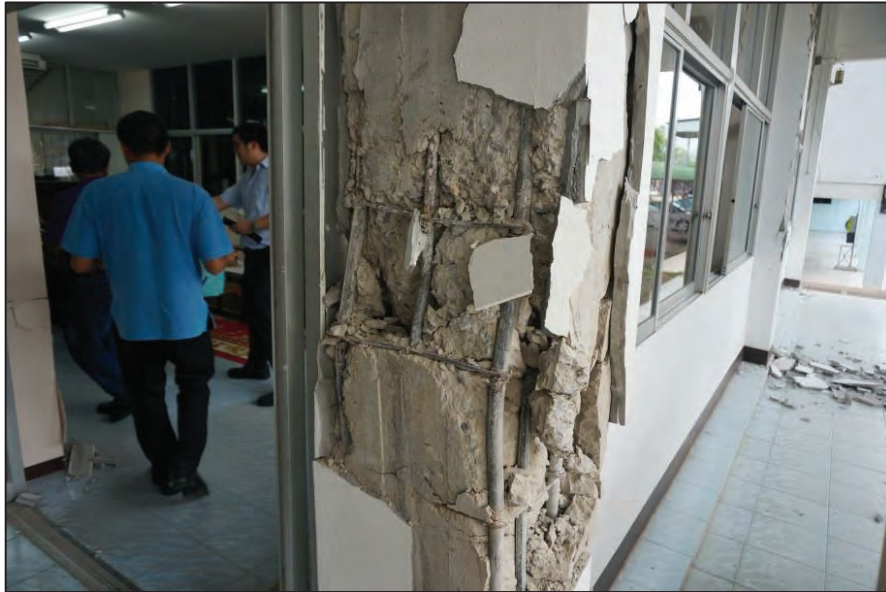
รูปที่ 6 ลักษณะของอาคารที่มีความเสียหายระดับสีแดง
